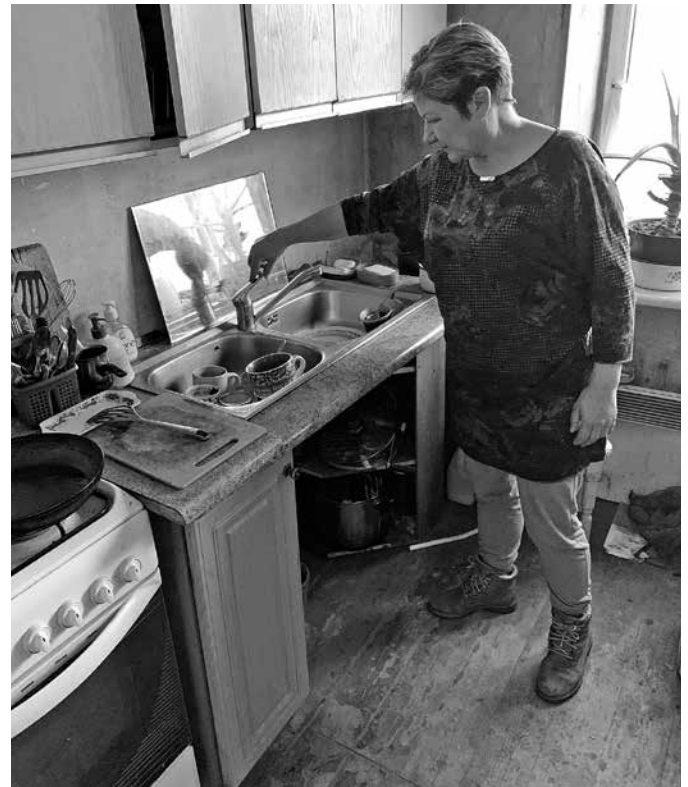
I det helt omoderna köket fungerar inte vattnet. Utvändigt har huset inte renoverats på 90 år.
