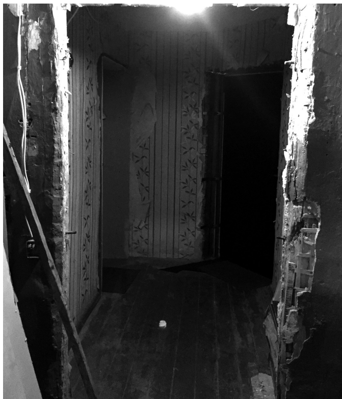
Vissa delar av trapphuset har rasat samman.
