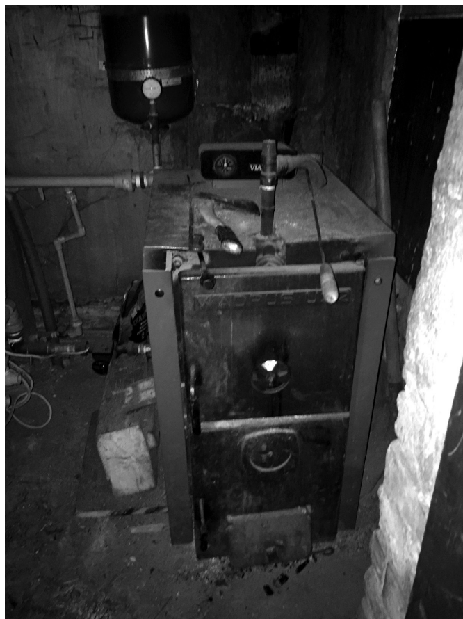
I trappuppgången finns en vedkamin och ett stort vedförråd. Kommunen har stängt av elvärmen kollektivt för samtliga hyresgäster eftersom så få har råd att betala för den.
